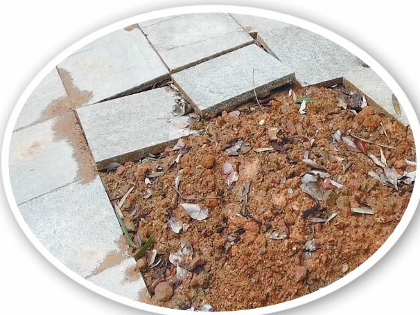
鹰潭高新区学前路行道树的树池未绿化覆盖，泥土裸露
