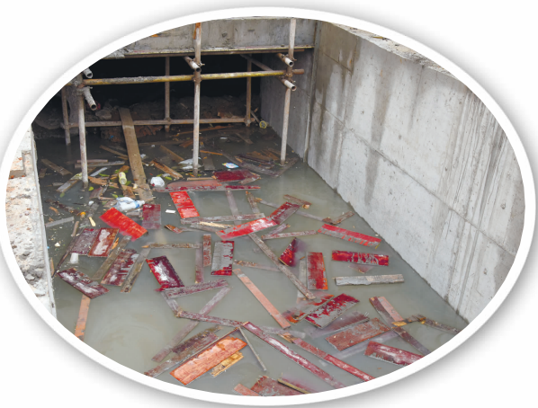
余江区何家桥巷水渠内垃圾堆积
